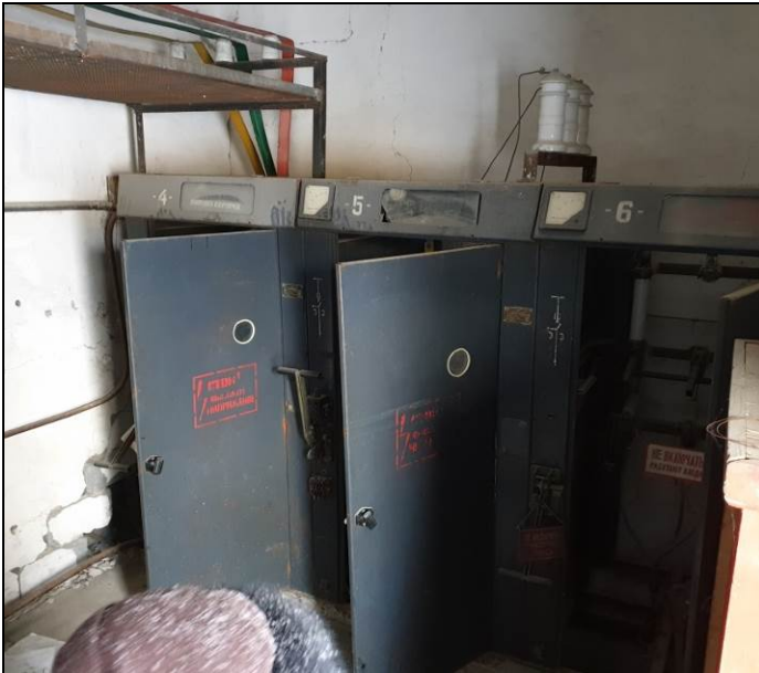
1а. Отсек ВН и НН трансформаторной подстанции ТМ630
