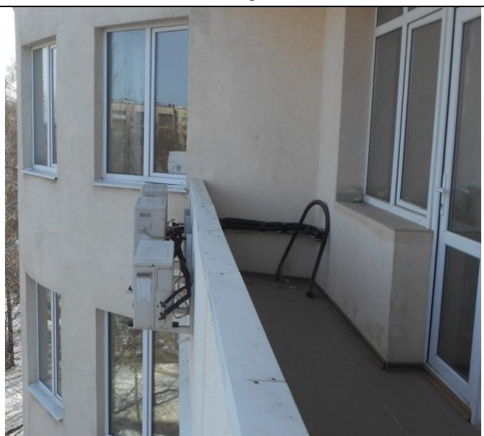
Выносные блоки систем кондиционирования
