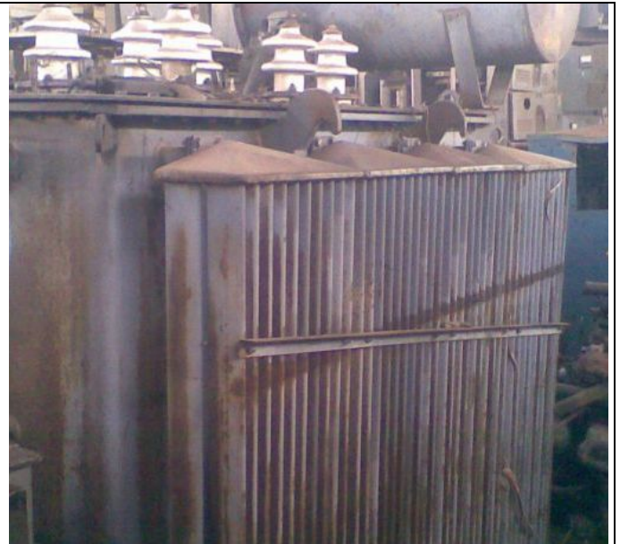
1б. Трансформатор ТМ630
