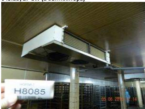
Фото 261 Установка холодильная, испаритель BV 452 E70 П (2 вентилятора)
