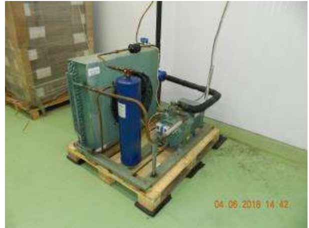
Фото 194. Конденсатор-чиллер Bitzer, 1 вентилятор
