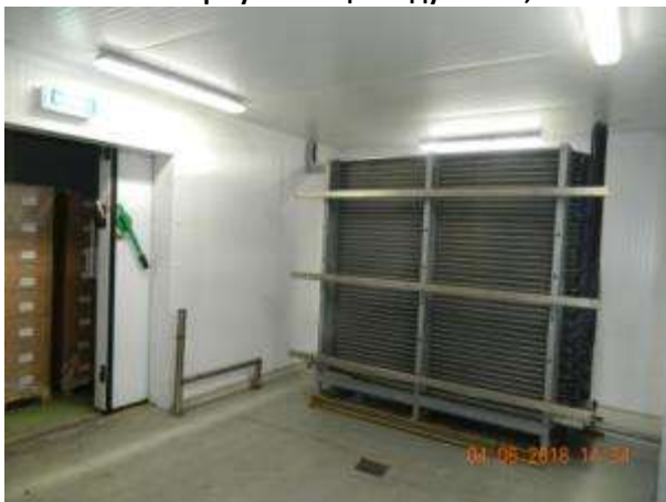
Фото 137 Установка холодильная, испаритель Guntner VT01161U (4 вентилятора)
