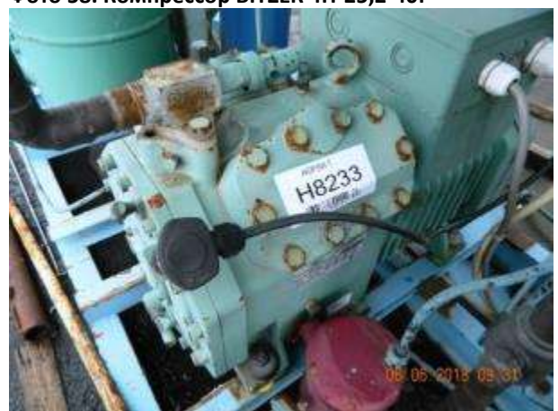
Фото 60. Компрессор BITZER 4H-25,2-40P
