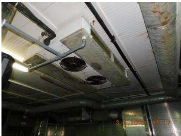
Фото 167 Установка холодильная, испаритель ВВ 452 Е45 П (2 вентилятора)
