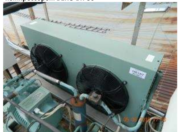
Фото 22. Холодильная установка (минус) с агрегатом АKE-L-4CE23Y-H-N1
