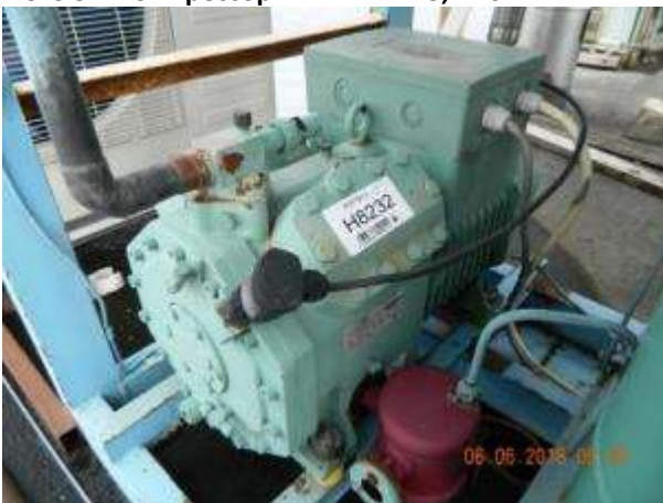
Фото 59 Компрессор BITZER 4H-25,2-40P
