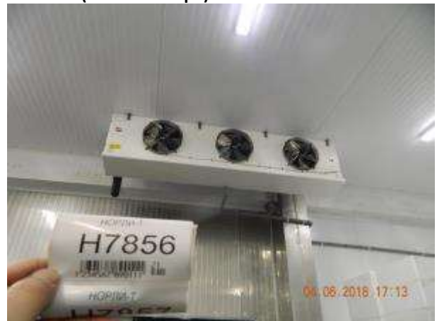
Фото 214. Установка холодильная, испаритель Guntner (3 вентилятора)
