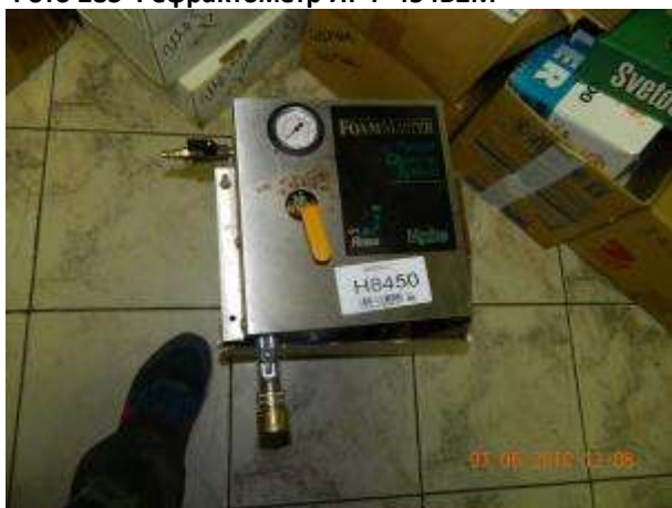
Фото 285 Станция пенная Foam Master
