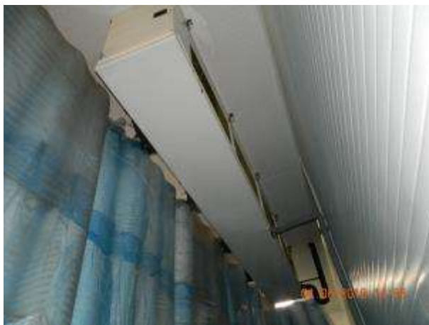
Фото 211 Установка холодильная, испаритель (4 вентилятора)
