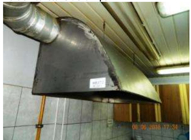
Фото 54. Зонт вытяжной, нерж.
