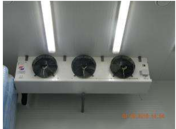
Фото 210. Установка холодильная, испаритель (3 вентилятора)
