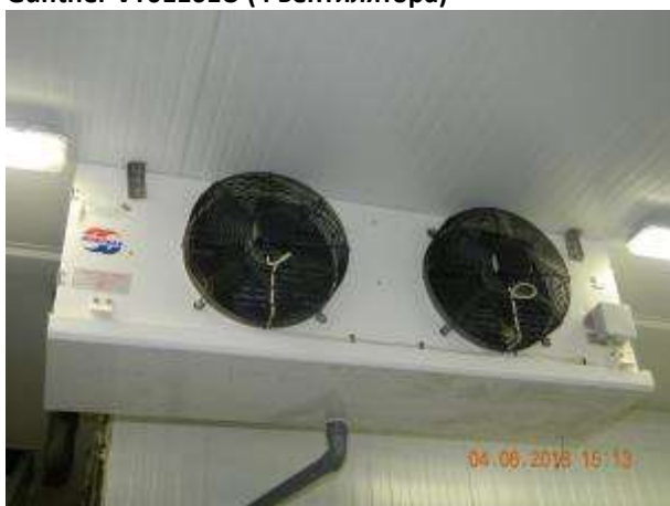
Фото 217 Установка холодильная, испаритель Guntner VT0605 (2 вентилятора)
