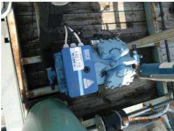
Фото 23 Холодильная установка шоковой заморозки с агрегатом Аk-MP-3-B-7451-60-H-45
