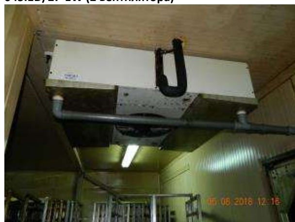
Фото 260. Установка холодильная, испаритель BV 451 G-70 П (2 вентилятора)
