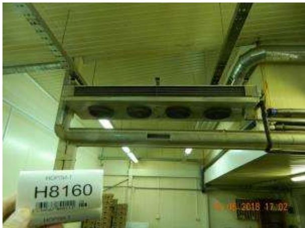
Фото 257 Установка холодильная, испаритель DFE34EH3ED (4 вентилятора)
