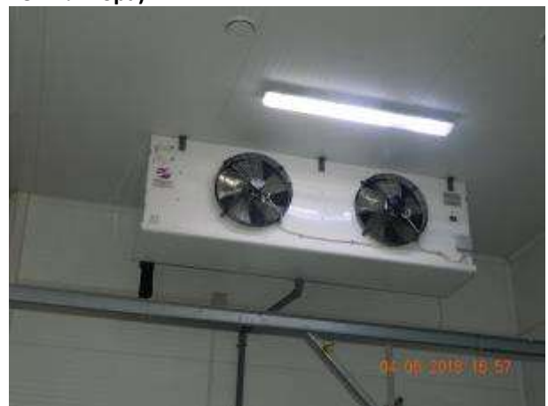
Фото 212. Установка холодильная, испаритель Guntner (2 вентилятора)
