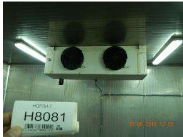
Фото 258. Установка холодильная, испаритель GHF 045.1D/27-EW (2 вентилятора)
