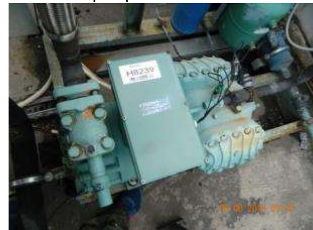
Фото 58. Компрессор BITZER 4H-25,2-40P
