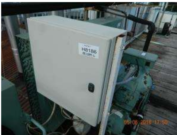
Фото 21 Холодильная установка (минус) с агрегатом АKE-L-4CE23Y-H-N1
