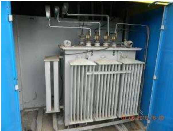
Фото 293 ТП 970 с трансформатором и прибором учета Меркурий 230 АМ-02
