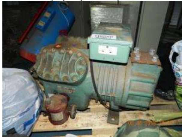
Фото 57 Компрессор BITZER 4H-25,2-40P
