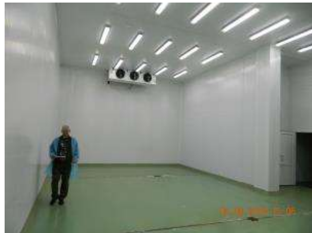
Фото 216. Установка холодильная, испаритель Guntner VT01285 (3 вентилятора)
