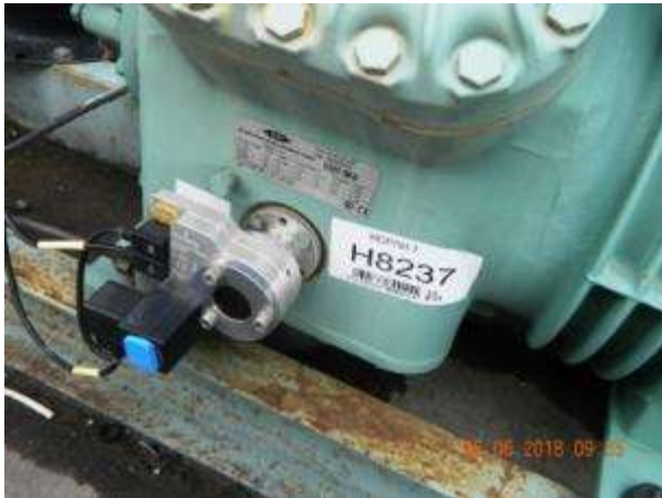
Фото 61 Компрессор BITZER 4H-25,2-40P
