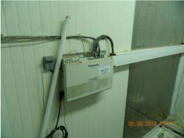
Фото 43 АТС Panasonic KX-TES824
