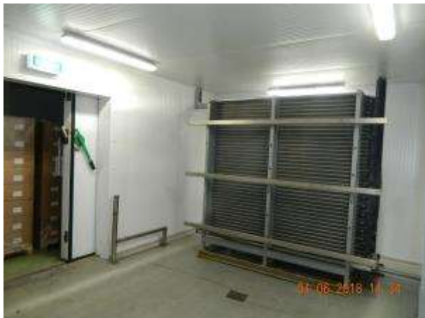
Фото 215 Установка холодильная, испаритель Guntner VT01161U (4 вентилятора)
