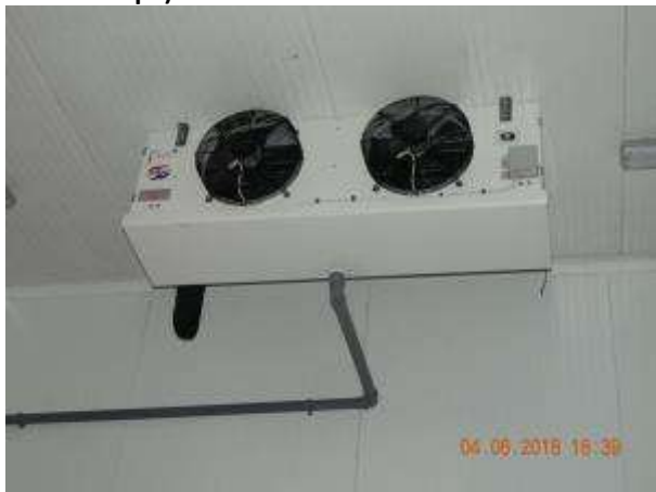
Фото 213 Установка холодильная, испаритель Guntner (2 вентилятора)
