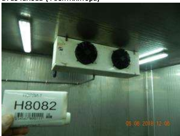
Фото 259 Установка холодильная, испаритель GHF 045.1D/27-EW (2 вентилятора)
