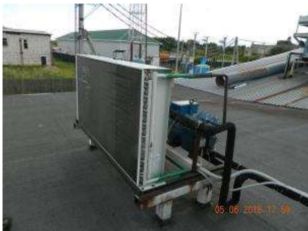
Фото 239 Конденсатор-чиллер Lloyd Coils Europe s.r.o. BP210K395
