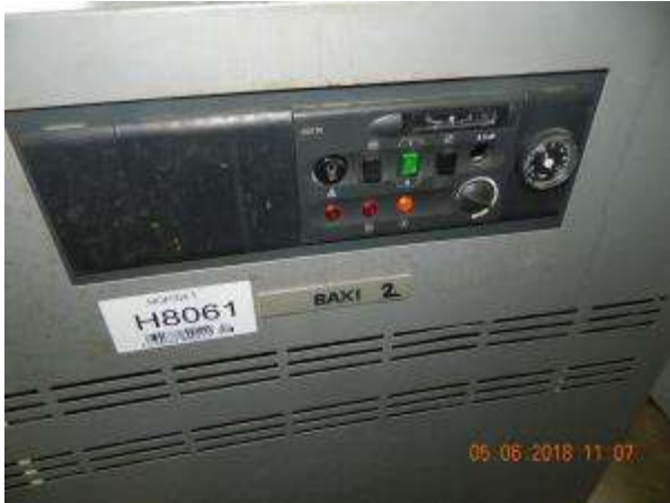
Фото 19 Газовый котел SLIM
