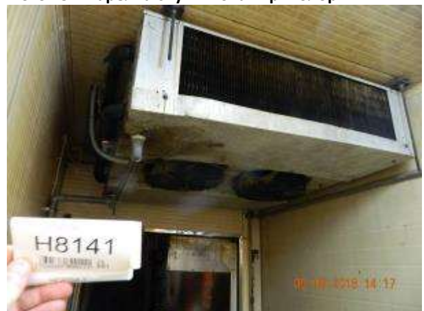
Фото 256. Установка холодильная, испаритель (2 вентилятора)
