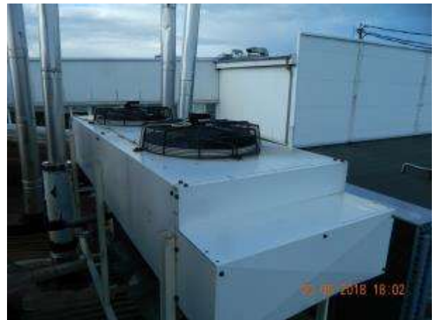
Фото 238. Конденсатор-чиллер CHR612424, 2 вентилятора
