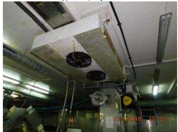
Фото 166. Установка холодильная, испаритель ВВ 452 (2 вентилятора)
