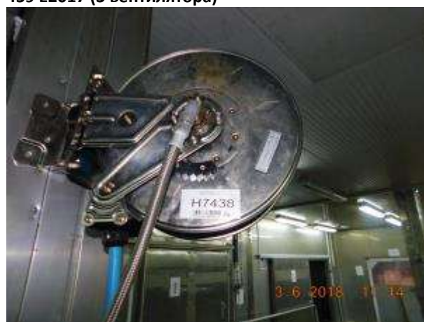
Фото 170. Шланг с катушкой Escodora
