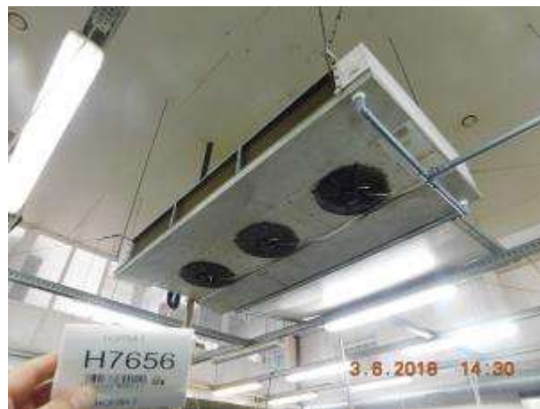
Фото 168. Установка холодильная, испаритель ВС 459 Е2017 (3 вентилятора)
