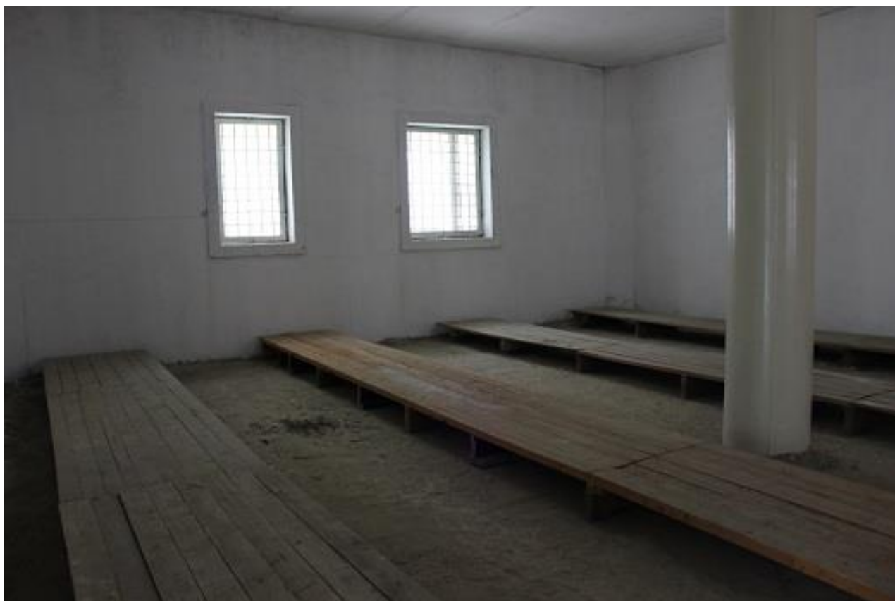
Фото 20. Хранилище взрывчатых веществ, литер И
