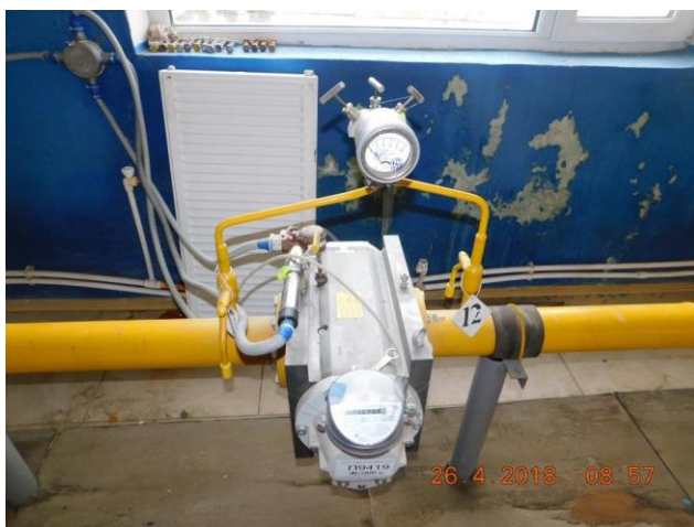
Основные средства (оборудование ГРП)
