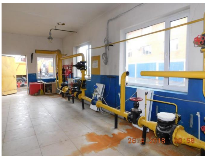
Основные средства (оборудование ГРП)
