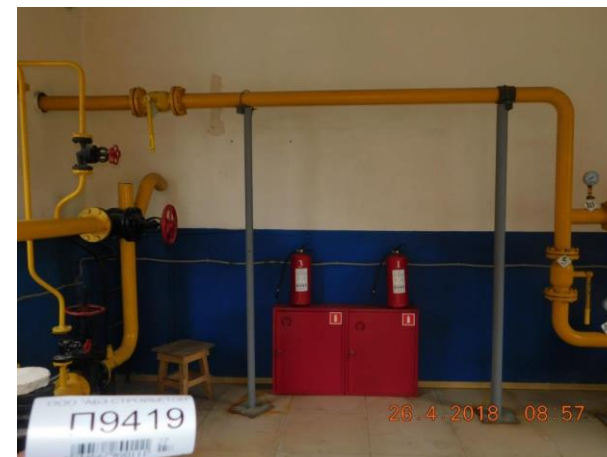
Основные средства (оборудование ГРП)
