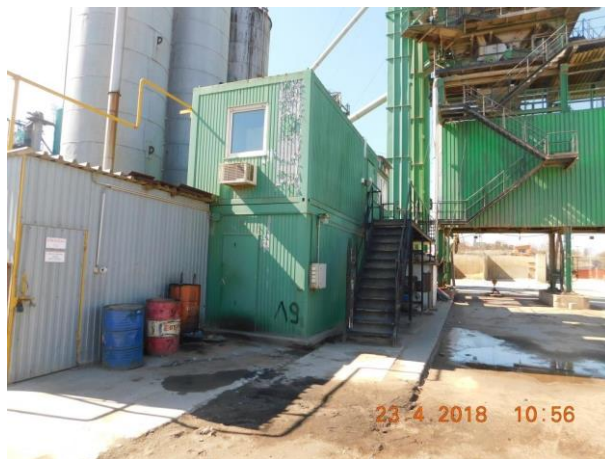
Сооружение Асфальто-смесительная установка "Teltomat 240"
