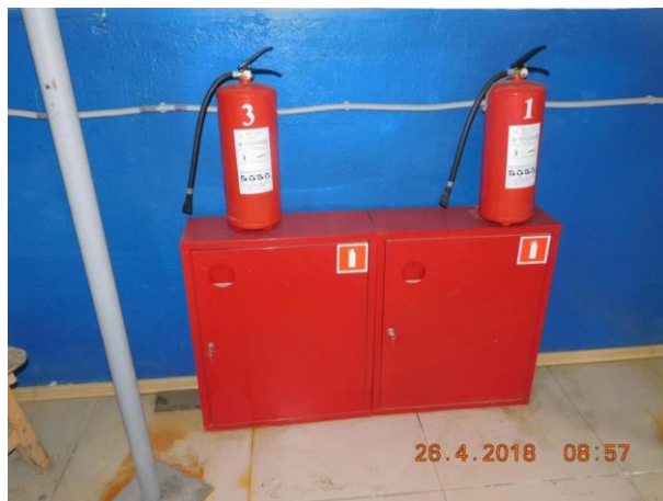
Основные средства (оборудование ГРП)
