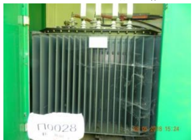
Фото 4 Подстанция КТП ТВ-400 кВА 10/0,4 кВ с трансформатором ТМГ11-400/10/0,4
