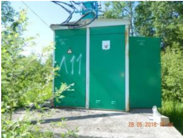
Фото 3 Подстанция КТП ТВ-400 кВА 10/0,4 кВ с трансформатором ТМГ11-400/10/0,4
