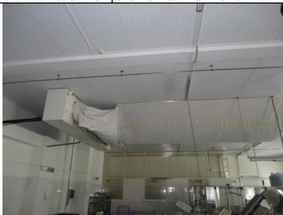
31. Холодильная установка "Bitzer"
