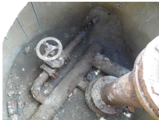
Рисунок 7.19. Элементы системы водоснабжения производственной площадки
