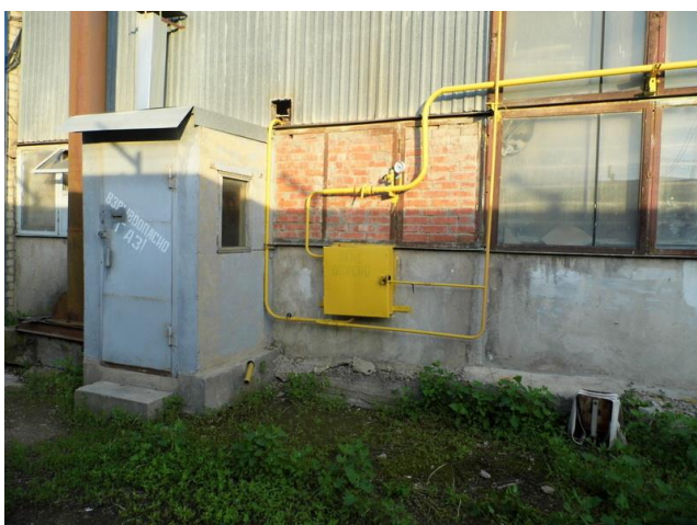
Рисунок 7.26. Элементы системы газоснабжения и отопления производственной площадки (ГРП)
