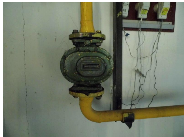
Рисунок 7.31. Элементы системы газоснабжения и отопления производственной площадки (АБК-2, прибор учета)
