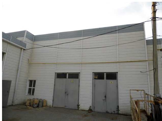
Рисунок 7.25. Элементы системы газоснабжения и отопления производственной площадки (газопровод)
