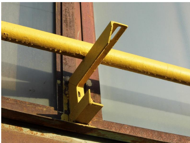
Рисунок 7.24. Элементы системы газоснабжения и отопления производственной площадки (газопровод)
