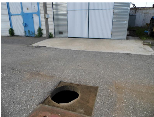
Рисунок 7.20. Элементы системы водоснабжения производственной площадки
