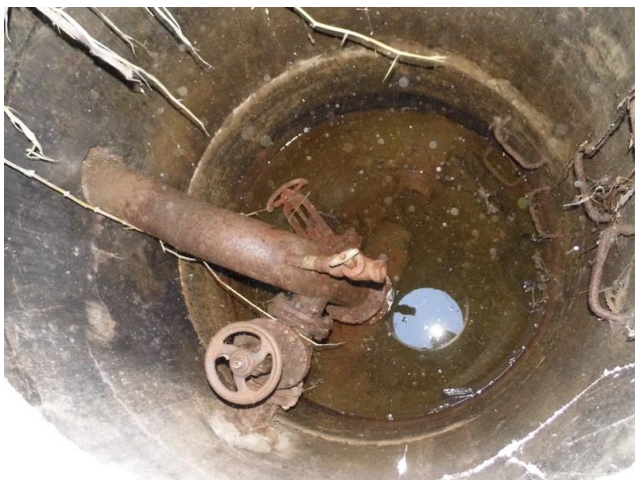
Рисунок 7.18. Элементы системы водоснабжения производственной площадки
