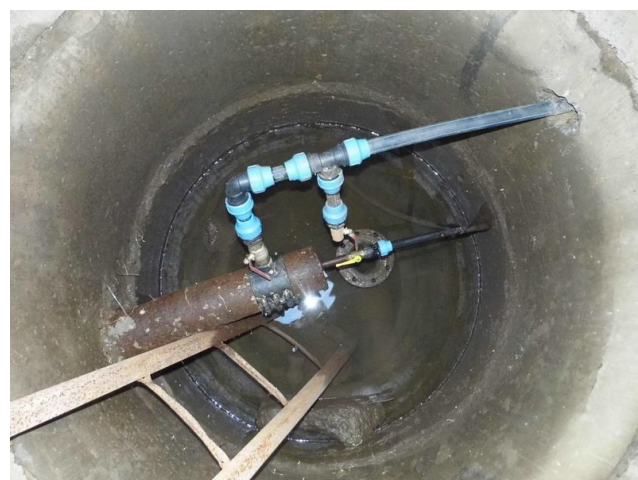
Рисунок 7.21. Элементы системы водоснабжения производственной площадки
