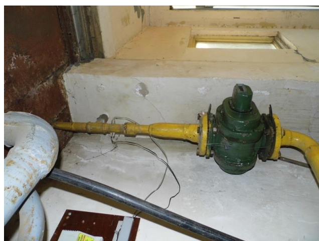
Рисунок 7.29. Элементы системы газоснабжения и отопления производственной площадки (прибор учета)
